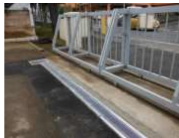
雨水が流れ込むように工事が施された正門付近
