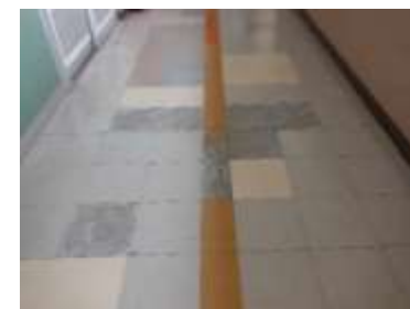
Pタイルの破損が激しく、見た目が残念な3校舎2階の廊下
